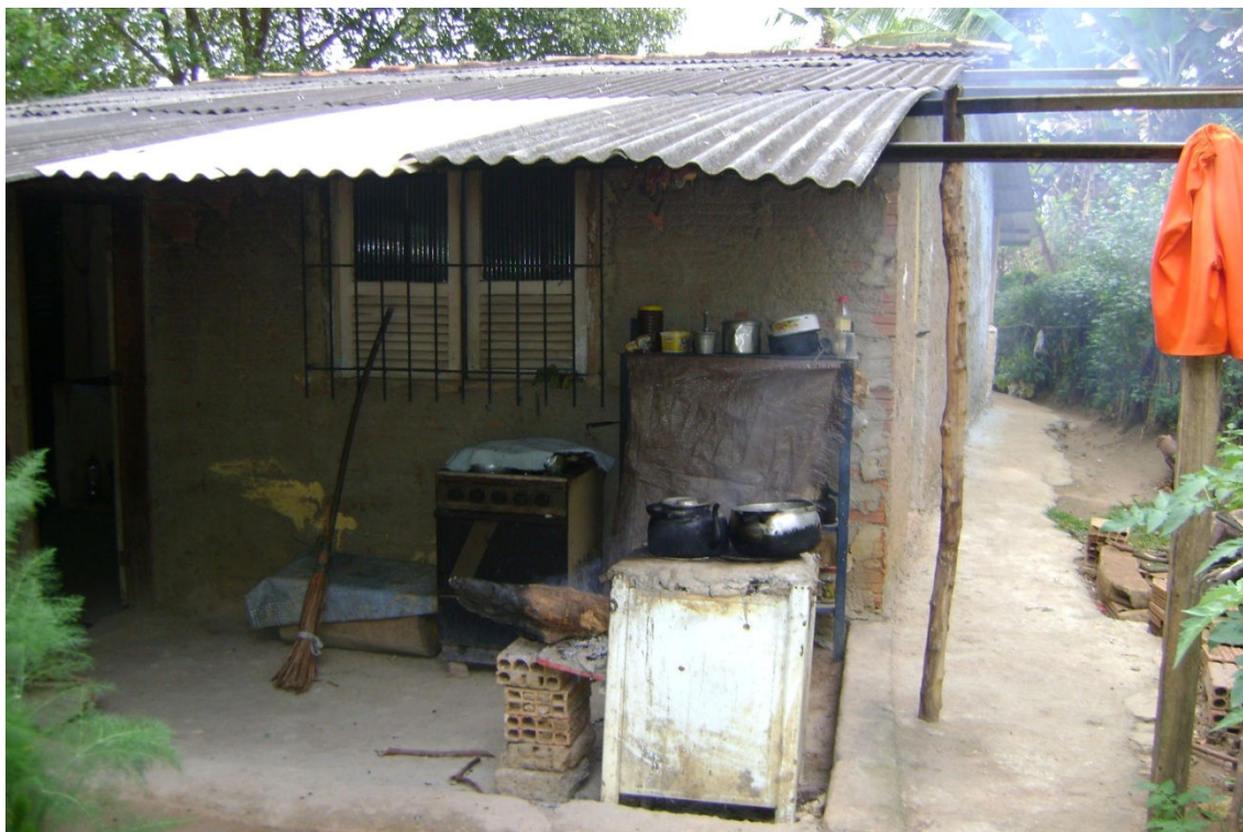
Figura 8: casa de interlocutora, mostrando fogão à lenha e construção precária, com telhado de eternit. Fonte: Lopes, 2010.
