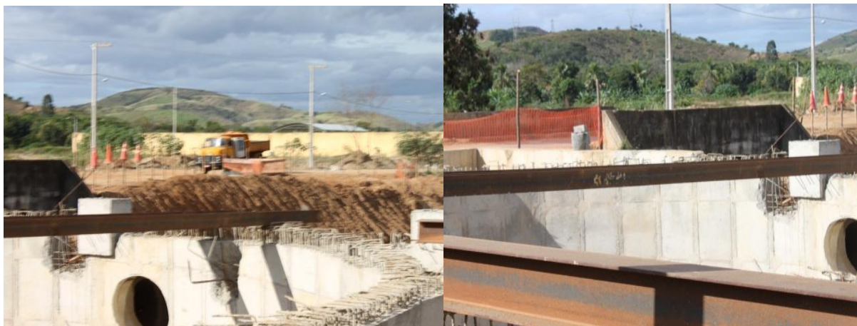
Figura 37 - Construção da elevatória da ETA – Estação de Tratamento de Água. Fonte: Fotos da Autora (2015).
