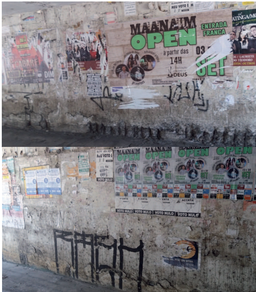
Figura 462 - Passarela subterrânea Usiminas. Pichação. Fonte: Acervo pessoal, 2016.
