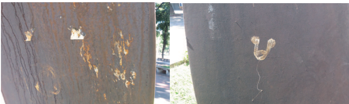
Figura 13 - Pichação, restos de papel e corrosão na obra de Amilcar de Castro
