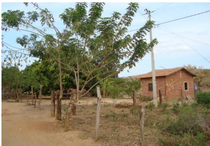
Figura 5 - Casa em construção no Assentamento Cachoeirinha, Tumiritinga, MG. 25/09/13 Fonte: Pesquisa de Campo, 2013.
